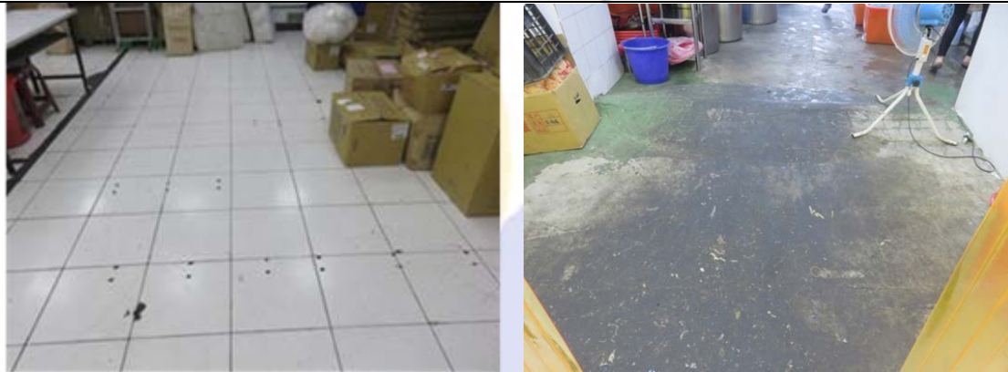
地面破損、不潔
