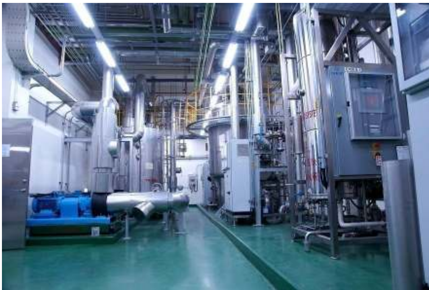
WFI water plant 水處理機房
