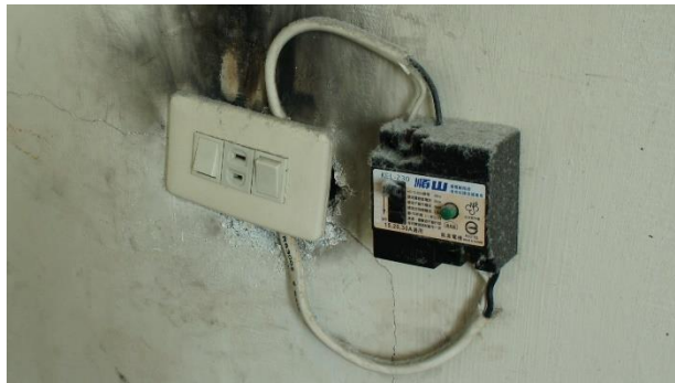
圖 12：插座設置漏電斷路器(資料來源：本計畫拍攝)
