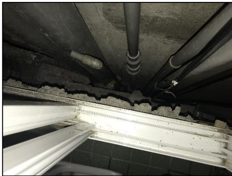
圖 23 管線貫穿垂直防火區劃
