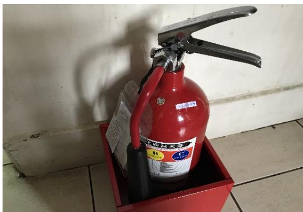
圖 26 5 磅 CO 2 滅火器(資料來源：本計畫拍攝)
