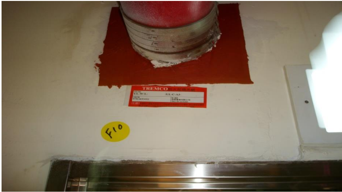
圖 22 管線貫穿水平防火區劃處以防火泥填塞
